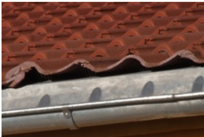
Bild: Dropp från takpannor av betong
